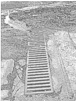
Rejilla que permite el ingreso de agua al sedimentador de grava. La entrada de agua se encuentra cubierta con tierra.
